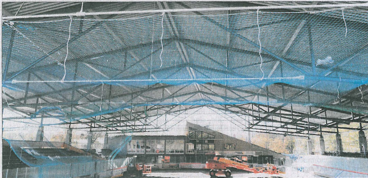
„Das ist schon fast Zauberei“: „Baulöwe“ Günther Karl hat der Deggendorfer Eishalle in nur drei Wochen ein neues Dach verpasst. – Foto: Binder
