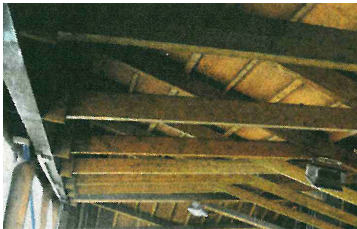
Die Tage der alten Holzkonstruktion sind gezählt. Bis zum 13. Oktober findet noch Eislaufbetrieb statt, dann wird das Dach abgebrochen.
